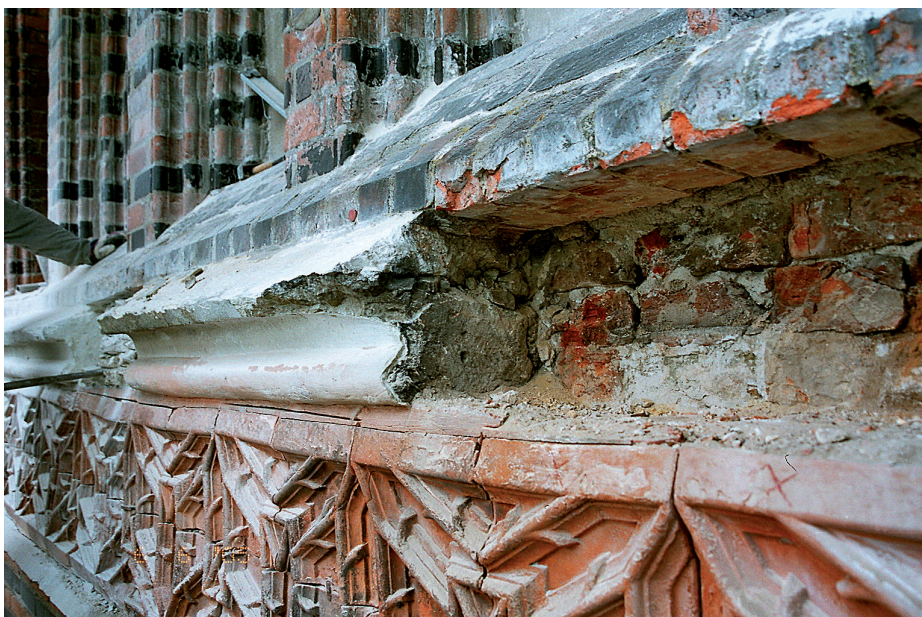
Brüche im Kalksteingesims
